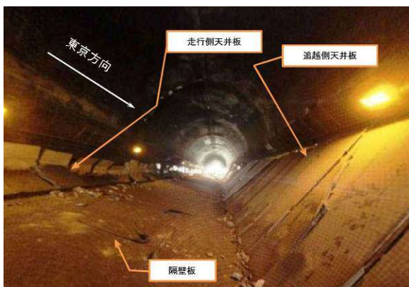
写真-3 天井板崩落状況
