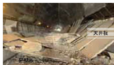
写真-4 天井板崩落状況
