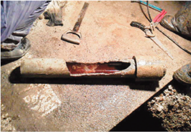
破損した石綿管
