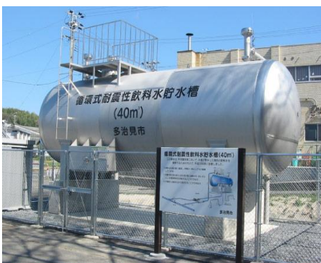
飲料水と兼用の耐震性防火貯水水槽
