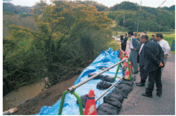
県道路肩崩落現場（奥山地区）
