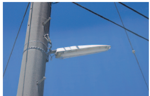
町内に設置されている防犯灯
