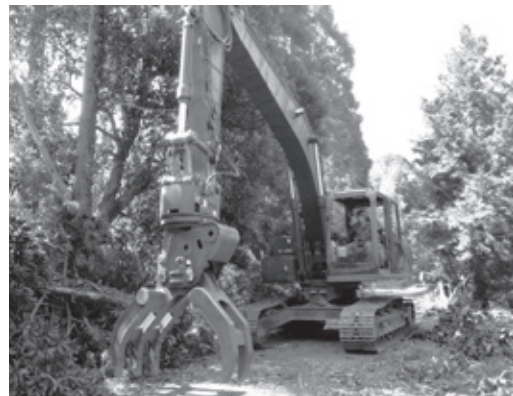
自衛隊による倒木の撤去作業(嶺岡林道)
