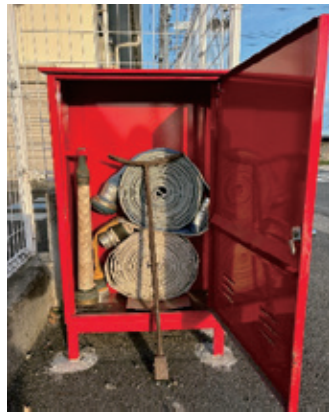
消火栓ボックス
