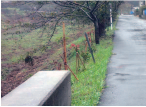
護岸延長を阻害している河川敷の桜
