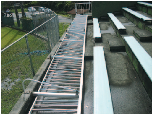
倒壊した岩井袋野球場観客席の手すり
