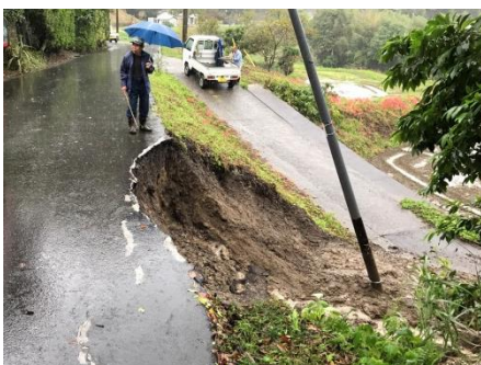
台風で被災した町道（大崩地）
