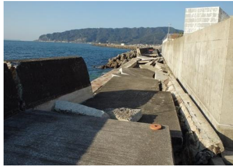
60mに渡り被災した護岸
