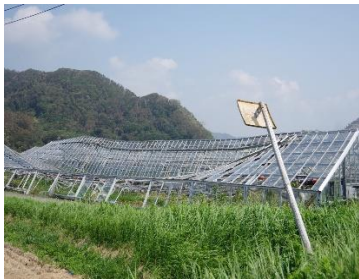
復旧は現在も続いている
