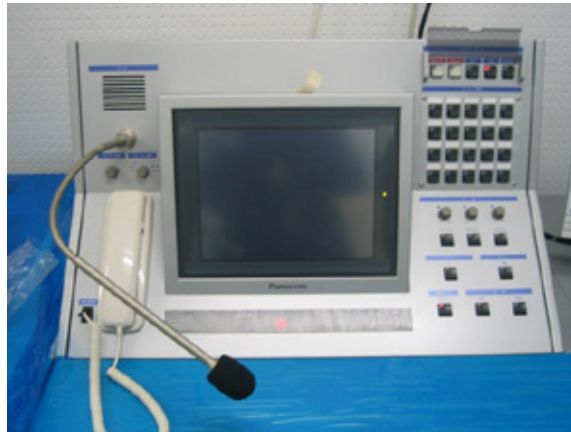
更新が必要な防災行政無線親卓設備
