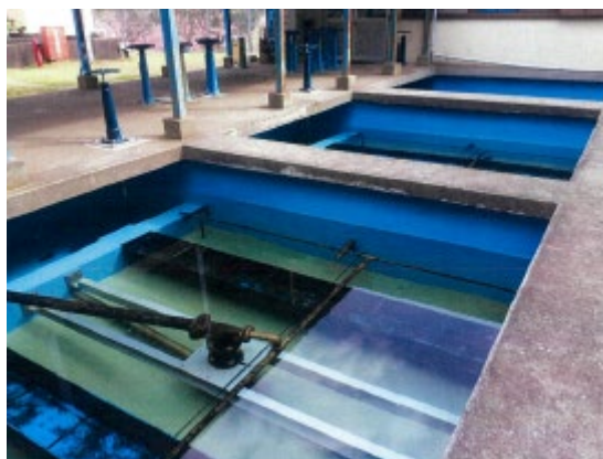
(鋸南浄水場 急速ろ過池)
