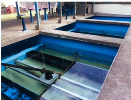
(鋸南浄水場 急速ろ過池)
