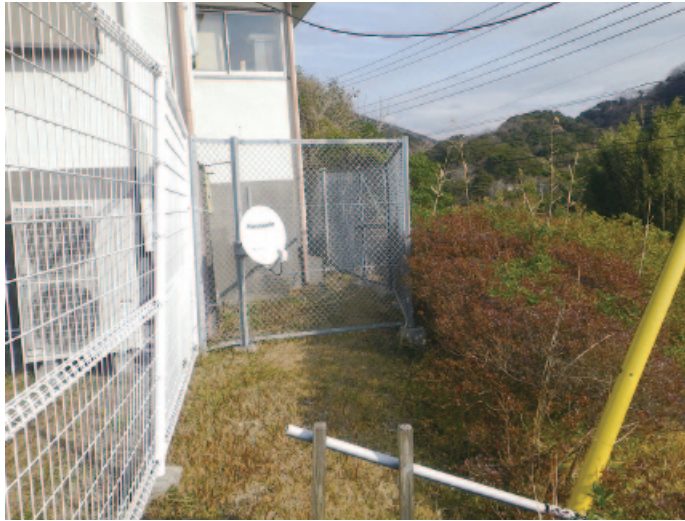
難視対策用アンテナ（鋸南町浄水場）
