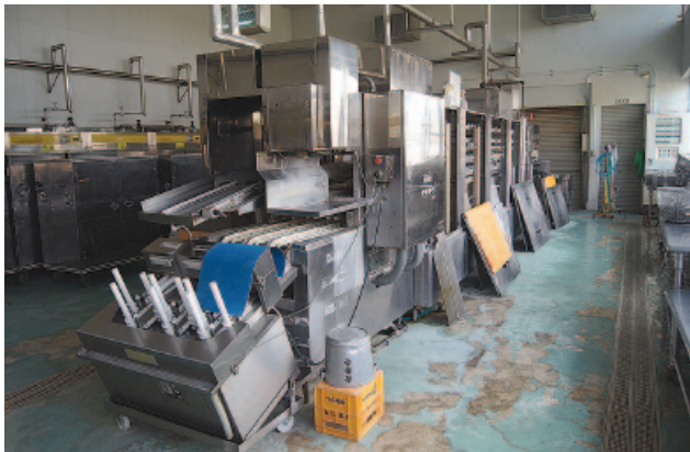
現在の給食センター食器洗浄機
