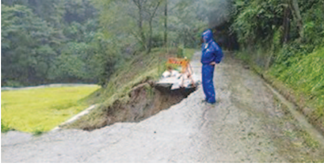
被災した町道2-205号線（小保田地先）
